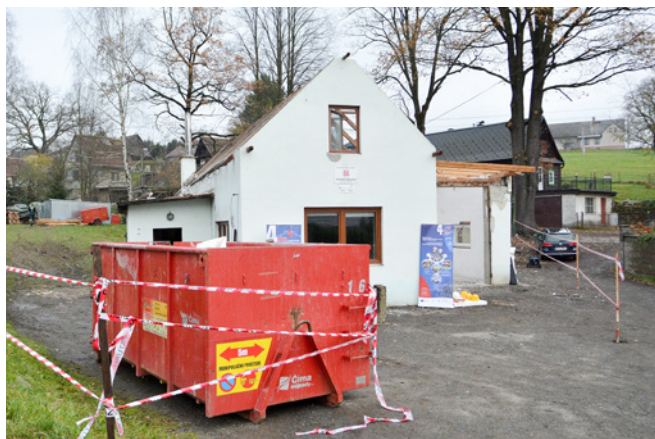
Zahájení výstavby nové hasičské zbrojnice v Krásné Studánce. Nová hasičárna se pak v roce 2019 stala pro občany nejzajímavější stavbou kraje. Získala Cenu veřejnosti v soutěži Stavba kraje 2019.
